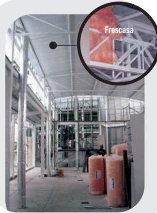
Aislamiento interno termoacústico tipo sandwich para cubierta metálica en la zona de oficinas y sala múltiple
