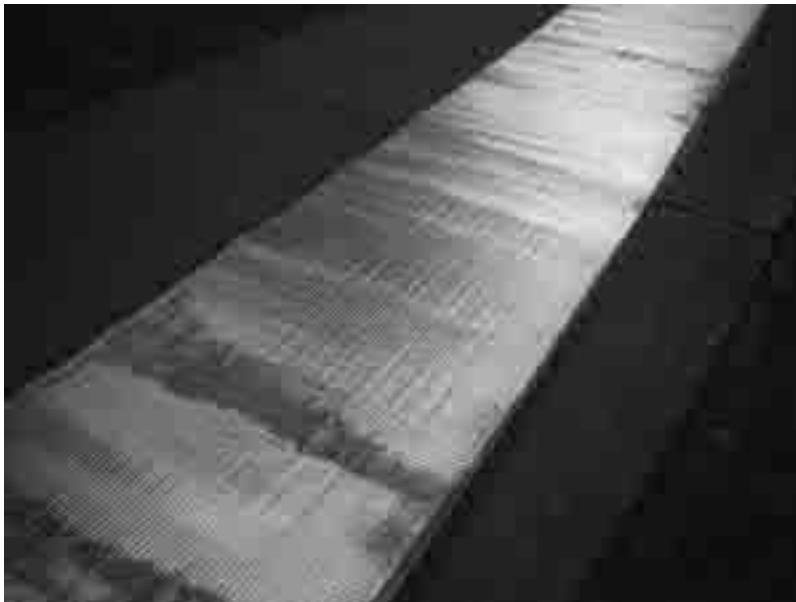
Manchas por corrosión.
